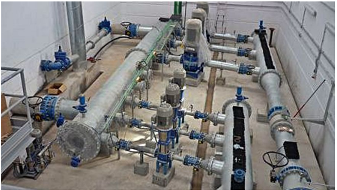
Interior de la desalinizadora. | ACUAMED
