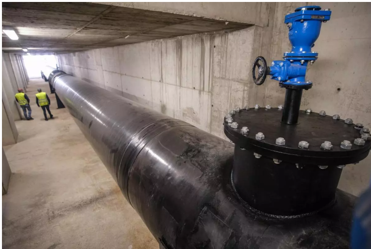
Imagen de la red de tuberías que llevan el agua hasta las instalaciones y que las repartirán entre los usuarios. / AXEL ÁLVAREZ
